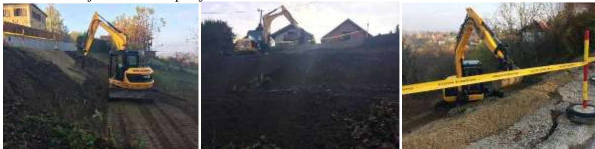
Slike sa sanacije klizišta u Županiji
